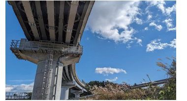
橋梁のメンテナンスを安全・容易にするFRP検査路(岩手県)
