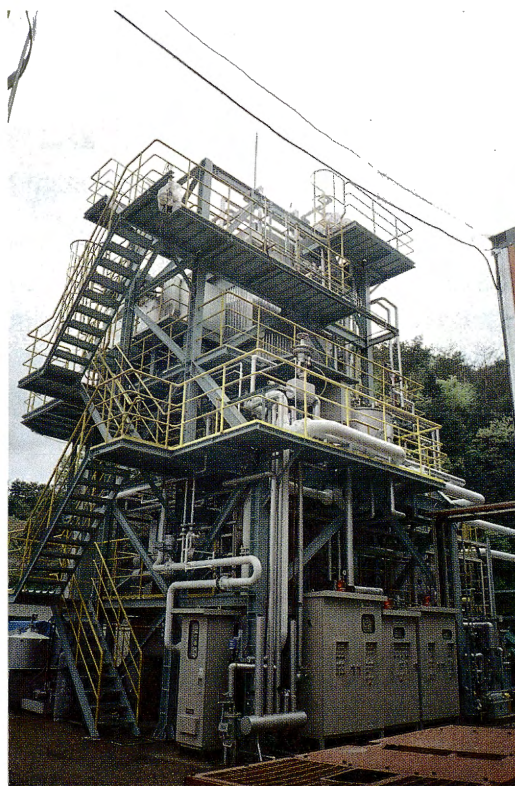
図4 RDF流動層ボイラ外観
