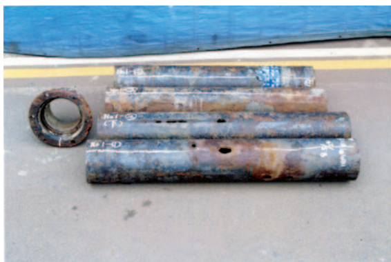
図1 腐食により漏水した管
