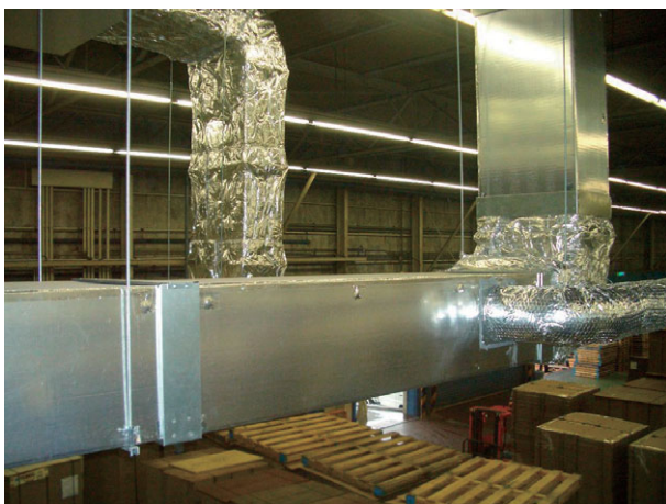
施工済みのダクト
