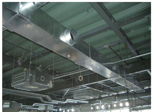
施工済みのダクト
