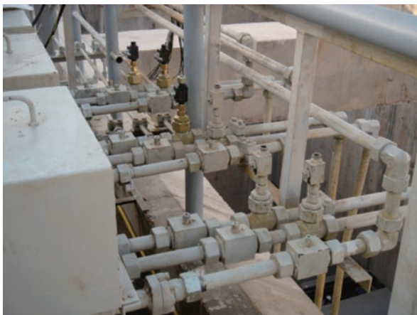
図10 油圧配管エア抜き用バルブ
