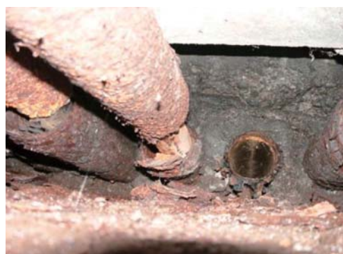
図2 金属製保護管の腐食状況
