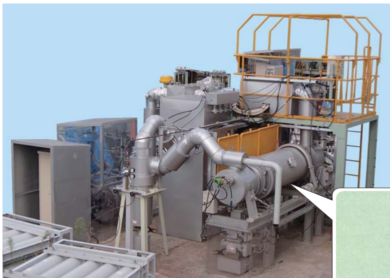
図1 試験設備外観
