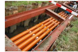
電力ケーブル保護管
