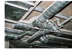
空調用ダクト
